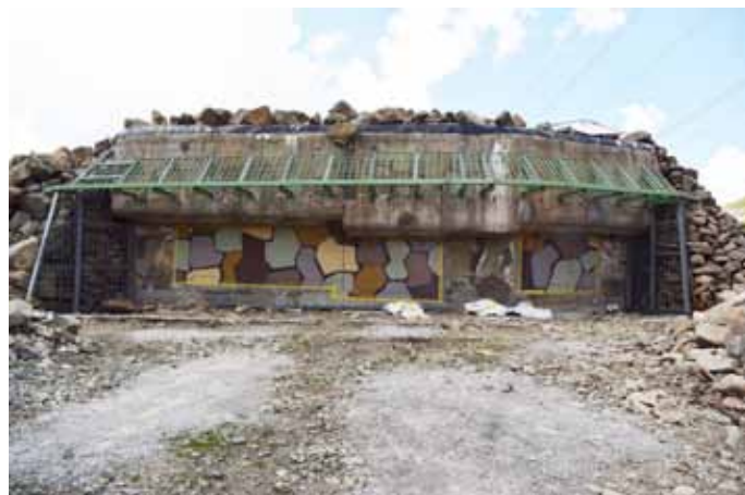
...und das instabile Trockenmauerwerk links und rechts mit einer vor Ort eingepassten Stahlkonstruktion stabilisiert.
