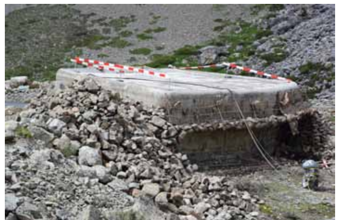
Der schadhafte Beton des Bunkerdaches muss stellenweise bis in eine Tiefe von 30 cm saniert werden.
