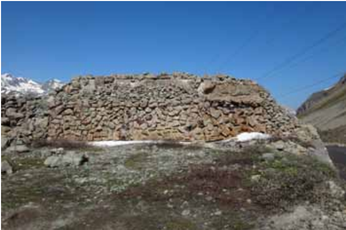
Baufällige, einsturzgefährdete Tarnung der Scharntentarnung vor Sanierungsbeginn.
