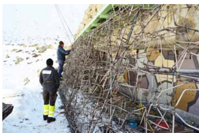
Die alten, restaurierten und verstärkten Tarnungstore werden vor der Rostschutzbehandlung probemontiert, damit nicht nach der Rostschutzbehandlung mit dem Schweißbrenner noch Korrekturen vorgenommen werden müssen.
